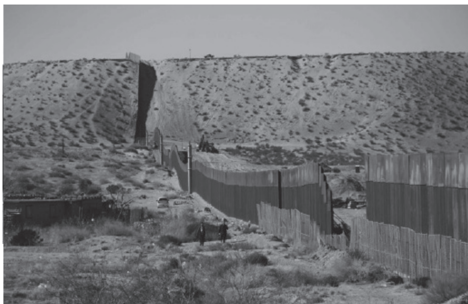
Figura 24. Remplazo de muro fronterizo Ciudad Juárez-El Paso
